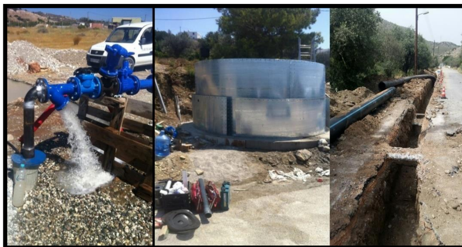
Εικόνα 19 Έργα ύδρευσης ΔΕΥΑΡ
