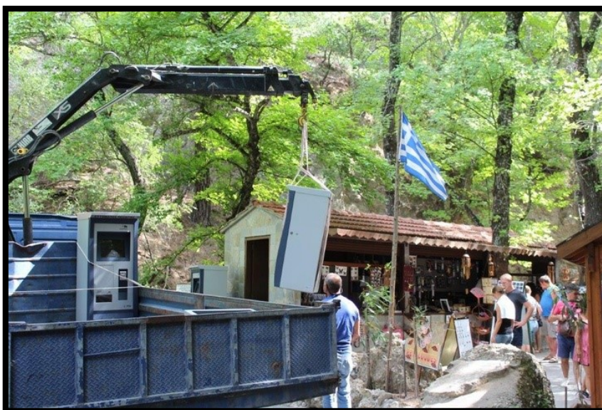
Εικόνα 33 Τοποθέτηση συστήματος ηλεκτρονικού εισιτηρίου στην κοιλάδα Πεταλουδών
